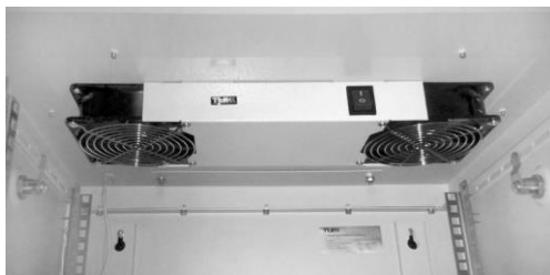
Установленный вентиляторный блок в шкафу
