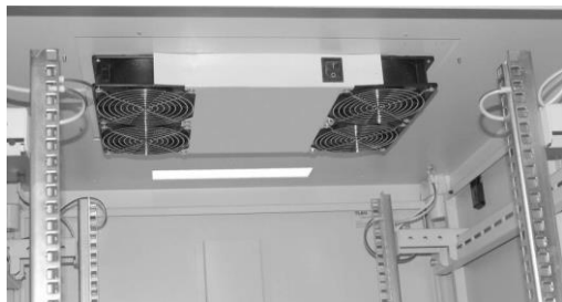
Установленный вентиляторный блок в шкафу
